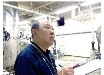
ボイラー室 作動を確認中
